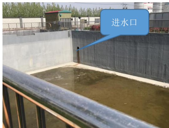
事故水池进水口
