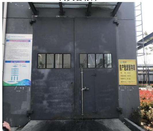
自产飞灰、灰渣暂存库
