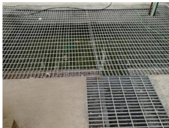
焚烧装置区废水收集沟
