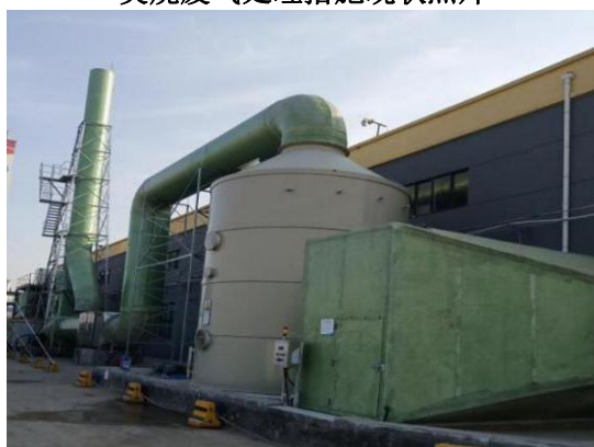
暂存车间废气处理措施照片
