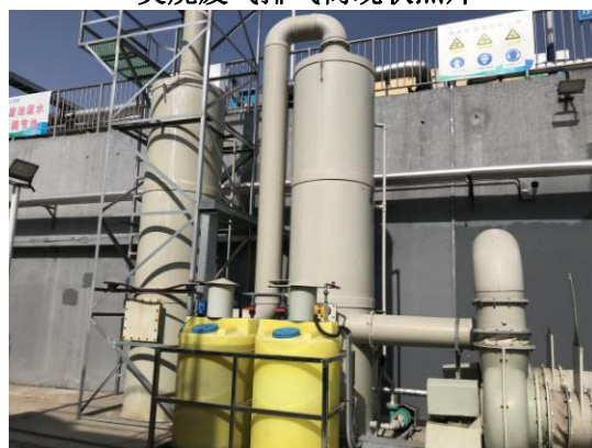
污水处理站废气处理措施照片
