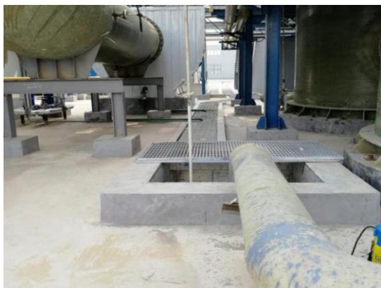
焚烧装置废水收集池
