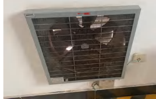
图6-6 110kV GIS 室排风扇
